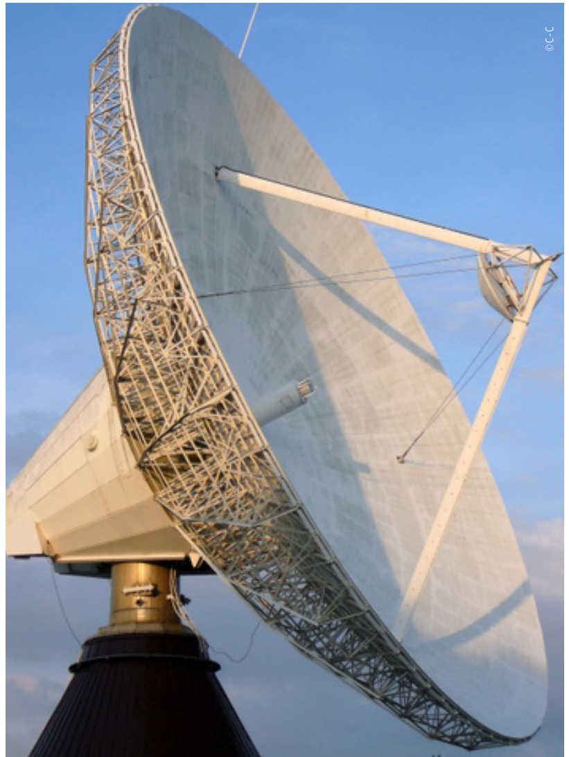
Esempio di antenna parabolica
